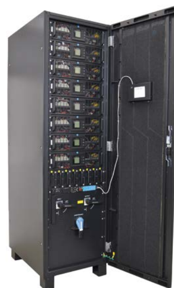
Кабинет ИБП на 320 кВА (8 силовых модулей по 40 кВА)
